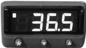
Pantalla del controlador de temperatura.
